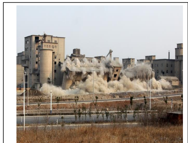
写真-2 国内数千の工場に閉鎖・爆破が命じられ、破壊されるセメント工場 (2014年3月)
